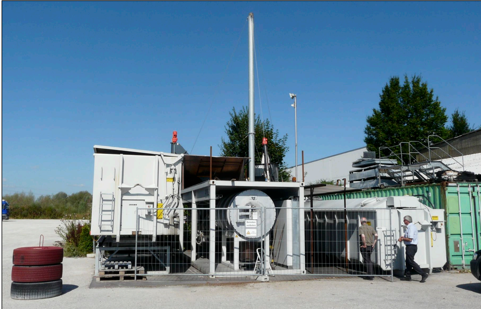
Thermische Karbonisierung: Pyreg-System
